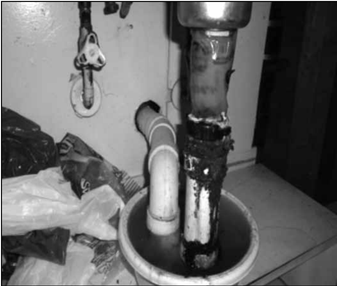
Logement ayant des déficiences au niveau de la plomberie, Stéphane Moreau, Comité logement Rive-Sud
