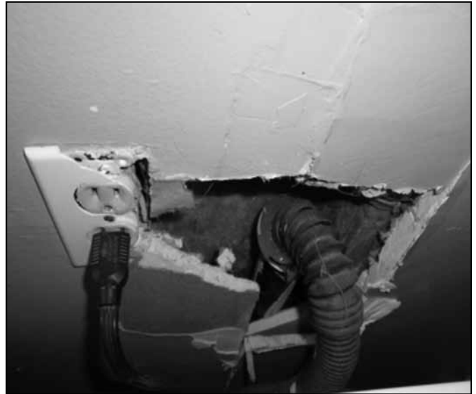
Logement ayant des déficiences au niveau de l'électricité, Stéphane Moreau, Comité logement Rive-Sud
